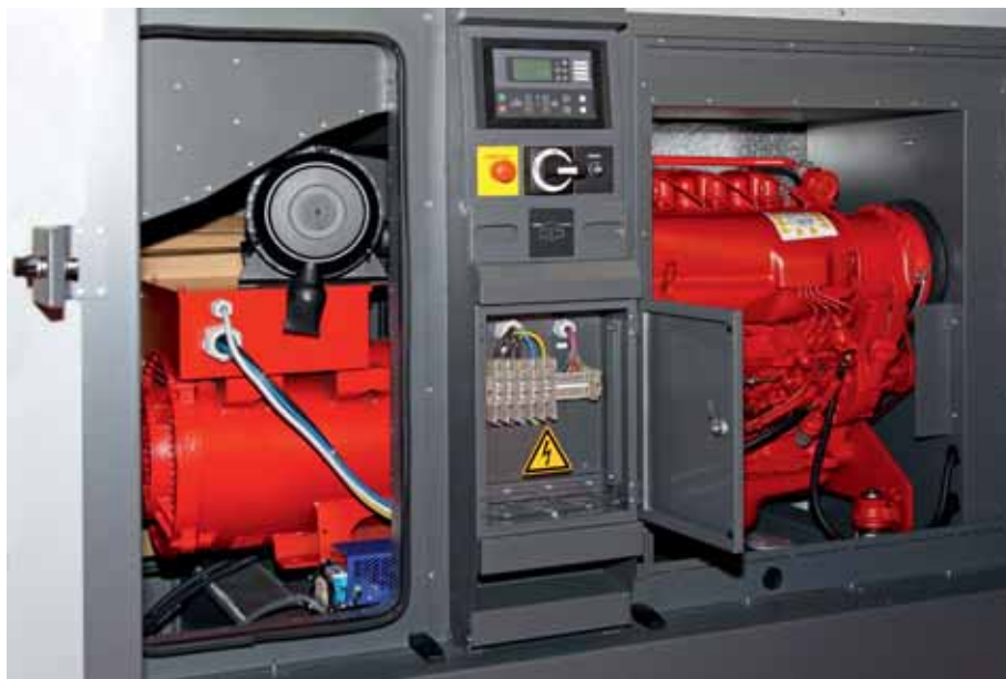
Diesलगenerator voor noodstroomvoorziening.
