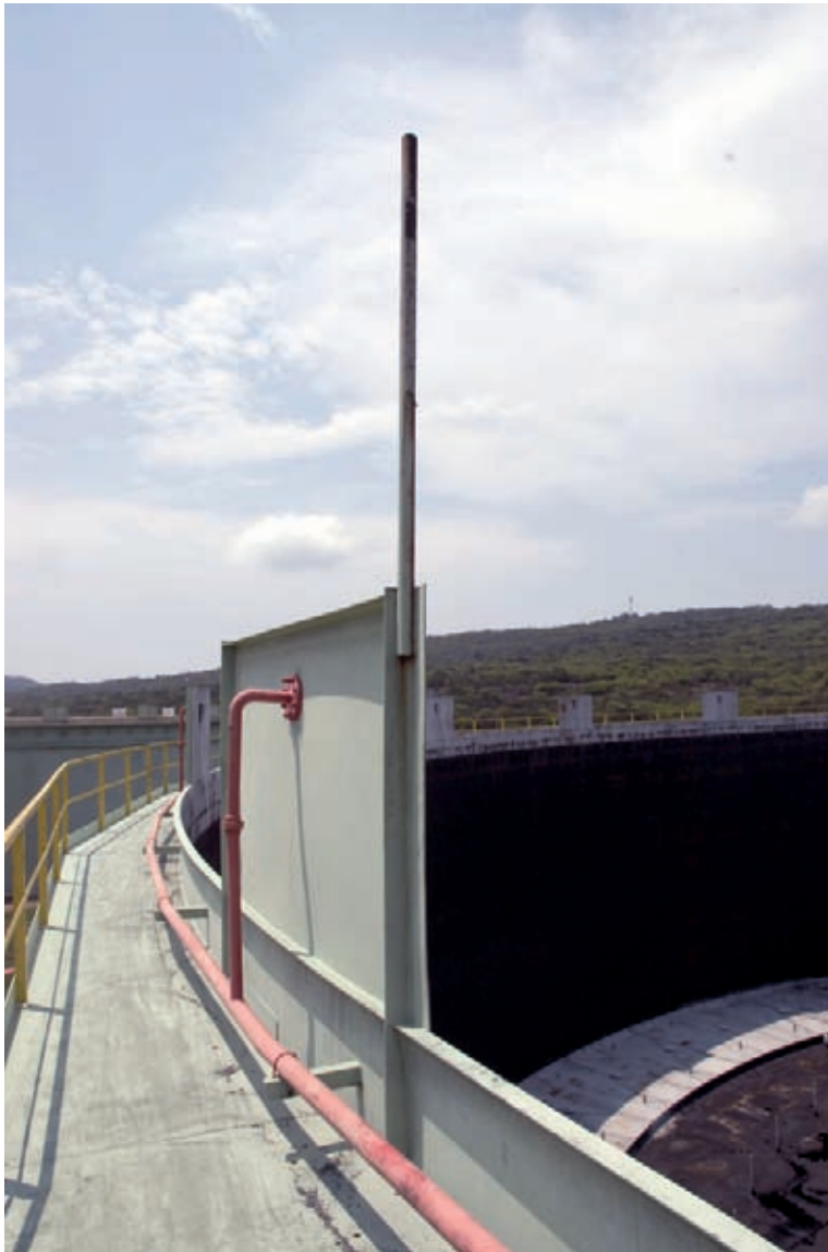
Figuur 9: steigerpijp op tank 1901. Bron: Onderzoeksraad
