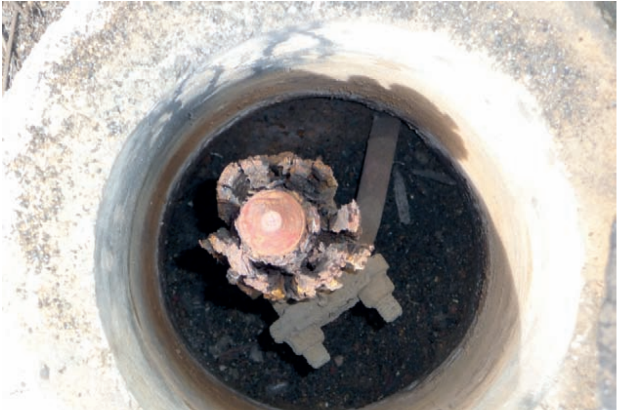
Foto 11: Tank 1934, gecorrodeerde aardpen
