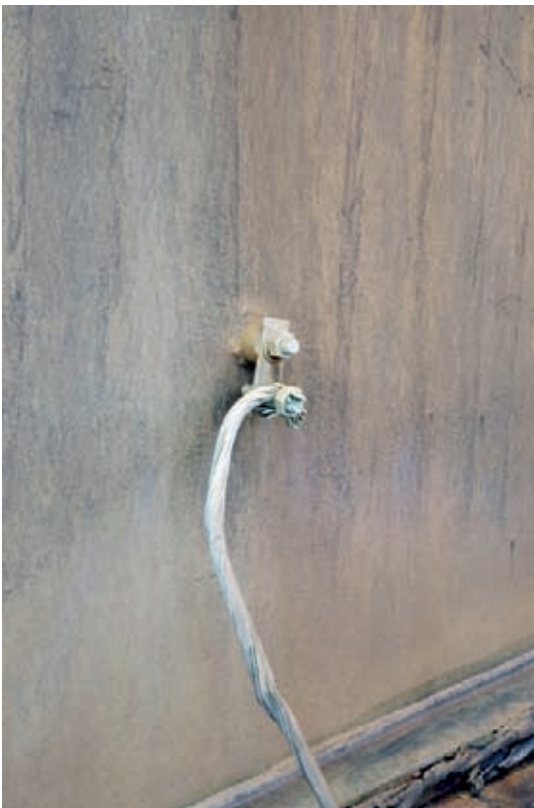
Foto 4: Tank 1931, aardverbinding, bedekt met verf
