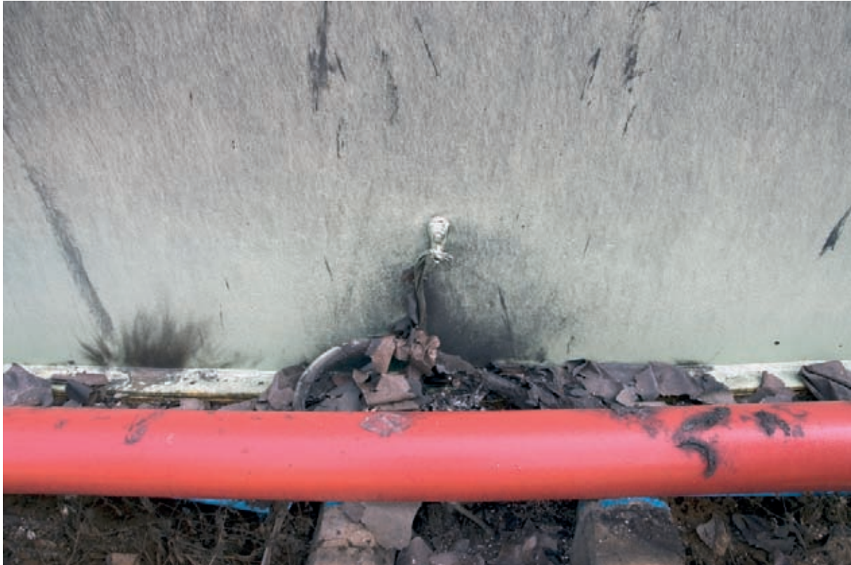
Figuur 7: De buitenkant van de tankwand van tank 1931 met links verse roetsporen ten gevolg van vonkoverslag, de aardkabel en aangesmolten elektriciteitskabel Bron: Onderzoeksraad
