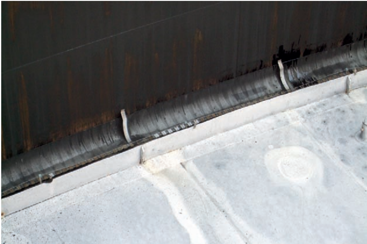
Figuur 10: het drijvend dak van tank 1901 met shunts boven de seal . Bron: Onderzoeksraad
