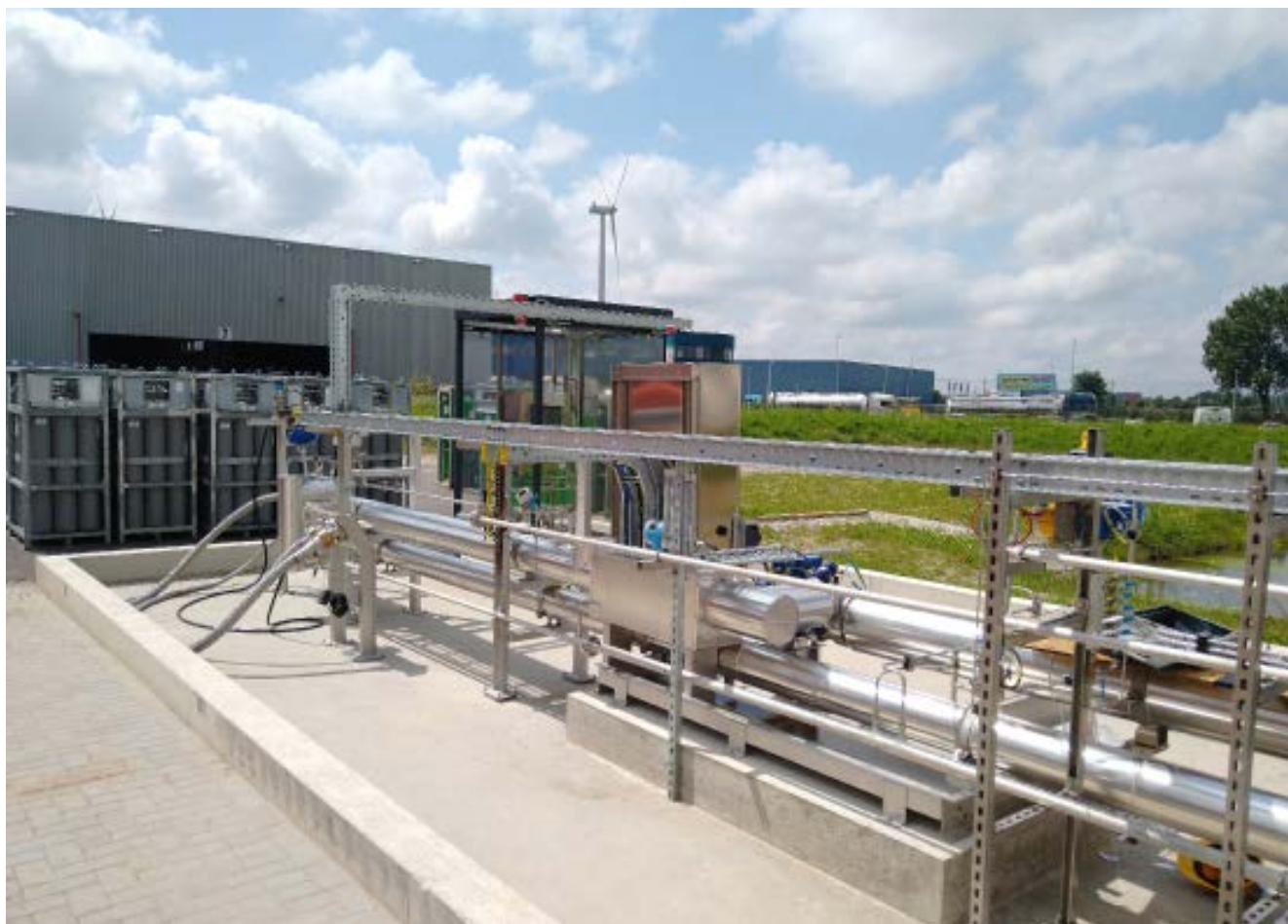
Een 'cleane' losplaats in een tankput.
